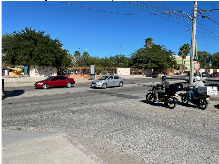
Figura 8.8 Estado del pavimento en el cruce
